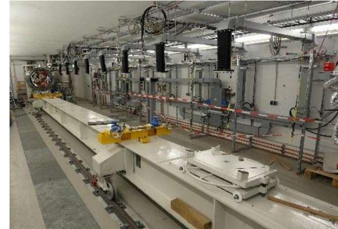
Cryomodule test stand
